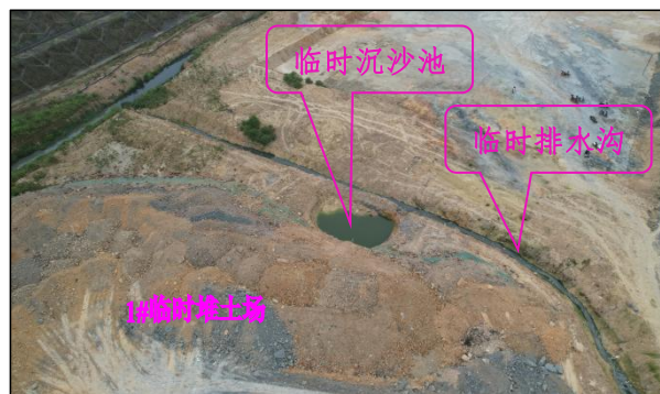
1#临时堆土场临时排水沟、临时沉沙池现状图，临时排水沟措施现状运行效果良好，临时沉沙池现状已堵塞，运行效果一般
