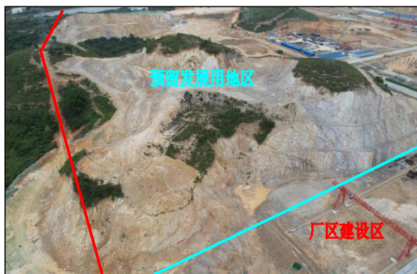
预留发展用地区北面现状图，边界处因高压线塔迁移施工和本项目建设施工，造成水土流失，但未造成水土流失危害
