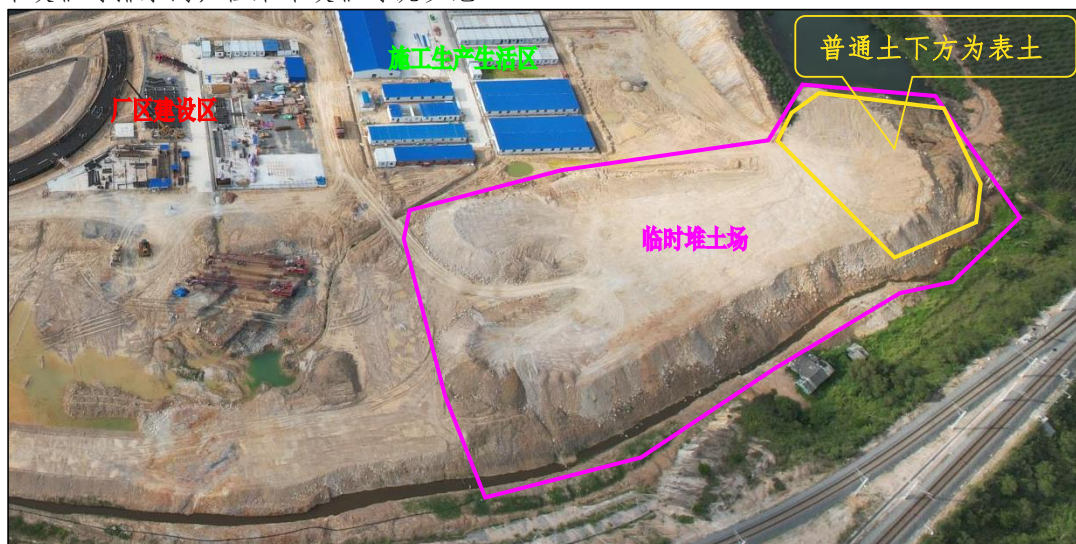
临时堆土场用地现状图，施工将其布设在预留发展用地区用地内南面，表土堆土场已并入临时堆土场用地中。场地排水采用施工前期布设的临时排水沟和施工生产生活区布设临时排水沟的形式，但无临时沉沙池、无纺布苫盖、彩钢板拦挡措施
