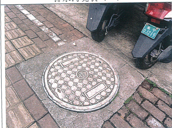
雨水检查井现状 (一)
